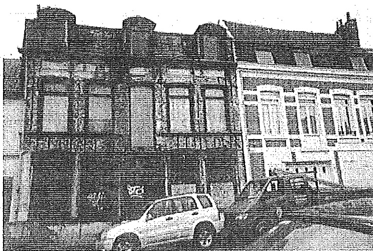
Figure 6: Maison murée mitoyenne avec une maison encore habitée
