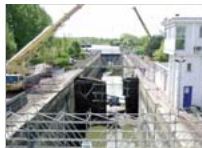
Avarie à une porte de l'écluse de Don, sur la Deûle
