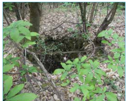
Illustration 1.25 : Puits d'aération d'une carrière souterraine, non protégé et non signalé, Louerré (49) [crédit Cerema Ouest, 2010]
