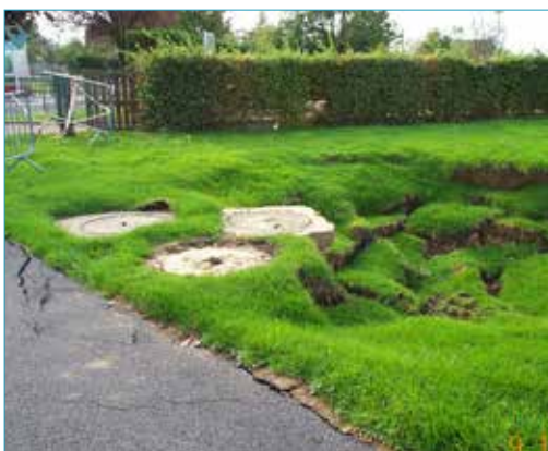
Illustration 1.18 : Effondrement d'un puisard causé par une suffosion, Beuzeville (27) [crédit Cerema Normandie-Centre, 2001]
