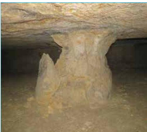
Illustration 1.7 : Pilier en surcharge dans une chambre souterraine à portée excessive du toit, Le Vieil-Baugé (49) [crédit Cerema Ouest, 2014]
