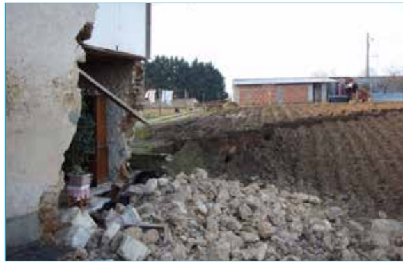
Illustration 1.28 : Effondrement du mur d'une habitation, Saint-Germain-du-Puch (33) [crédit Département de la Gironde, sd]
