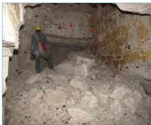
Illustration 1.11 : Chute de blocs dans une carrière souterraine, Montrelet (80) [crédit BRGM, 2010]
