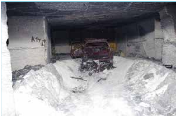
Illustration 1.32 : Restes calcinés d'un véhicule dans une carrière souterraine, Aisne [crédit INERIS, sd]
