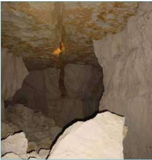
Illustration 1.6 : Chute de blocs à l'aplomb d'une fracture du toit, Mayet (72) [crédit Cerema Ouest, 2006]
