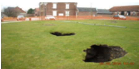
Effondrement à Cantaing-sur-Escaut - février 2014 (source BRGM)
